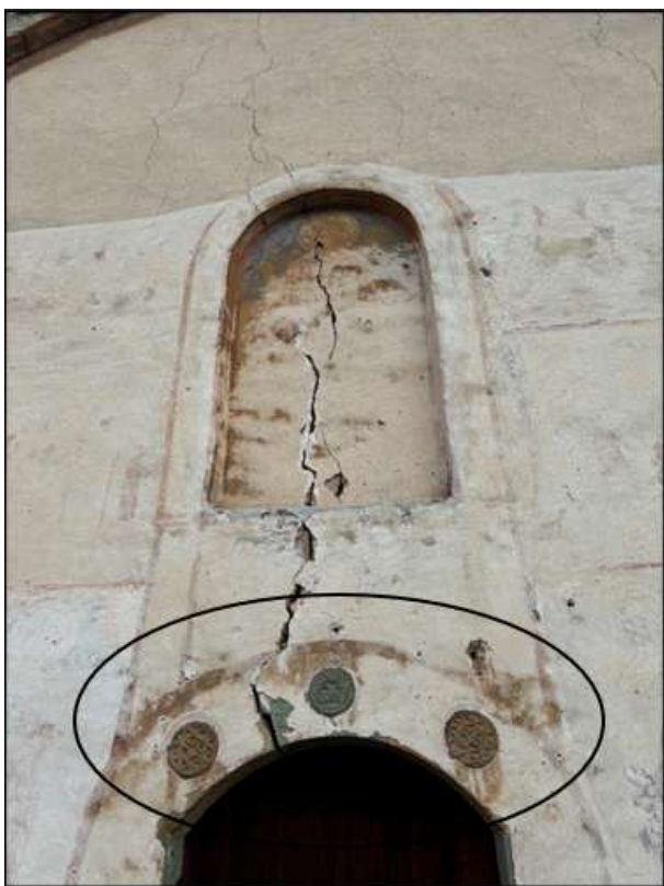
Фиг. 4. Орнаментална релефна украса върху западната врата на църквата. Ясно личат пукнатините върху фасадата на сградата. Личен архив, ноември, 2024 г.
